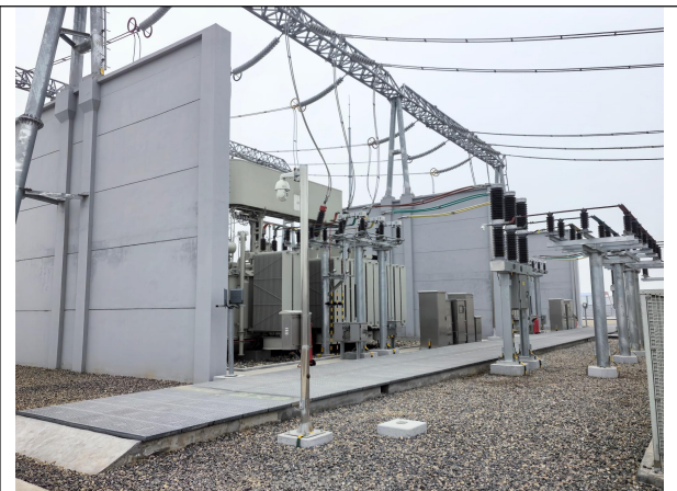
主变压器及防火墙
