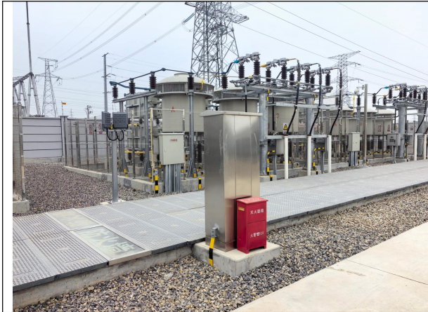
站内消防器材
