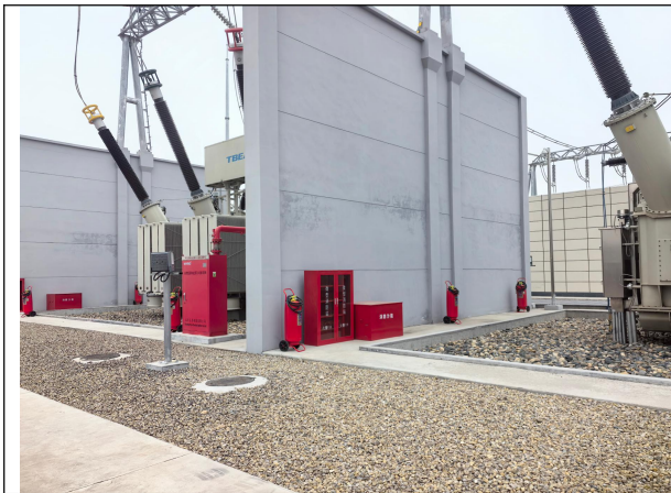
主变压器防火墙
