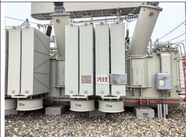
3#主变压器底部储油坑
