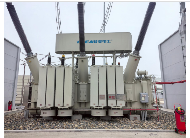
4#主变压器底部储油坑
