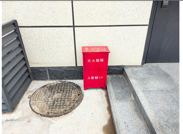
站内消防器材
