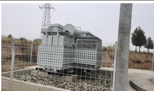
风机箱变事故油池
